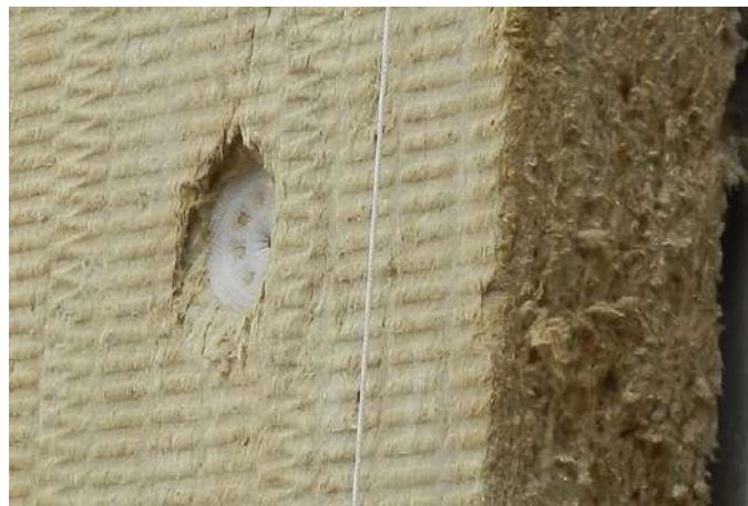
Primjer nepravilno postavljenje pričvrsnice
