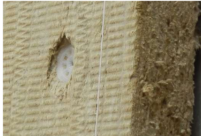
Beispiel eines fehlerhaft montierten Befestigungselements
