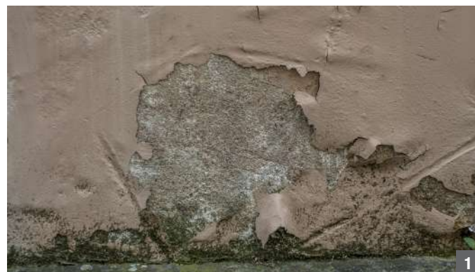
Feuchtigkeit im Untergrund
