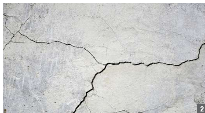
Vorhandensein von Rissen
