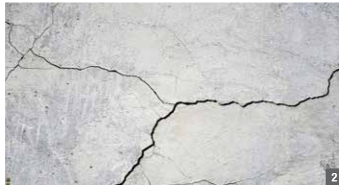
Vorhandensein von Rissen
