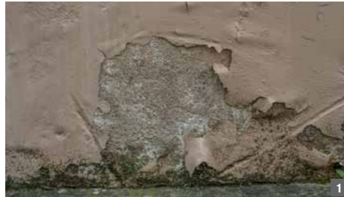
Feuchtigkeit im Untergrund
