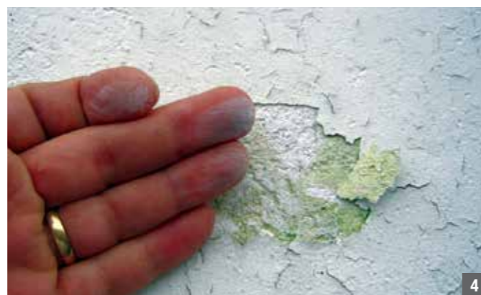
Feststellung von Staub und Ausblühungen an der Oberfläche
