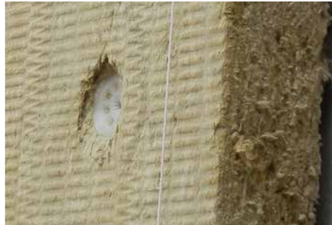
Beispiel eines fehlerhaft montierten Befestigungselements
